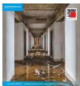
Für Instandsetzungsfähige Hochwasserschäden am Boden
