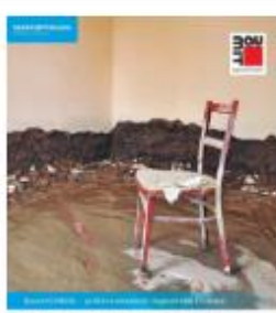
Für Instandsetzungsfähige Hochwasserschäden im Innenbereich
