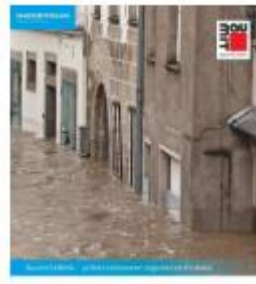
Für Instandsetzungsfähige Hochwasserschäden an der Fassade
